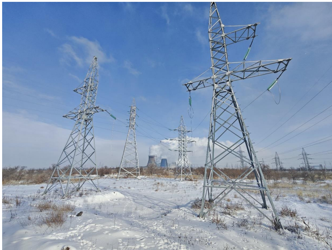
Питающая линия ВЛ110кВ «Сантехническая - Новый Майкудук»
